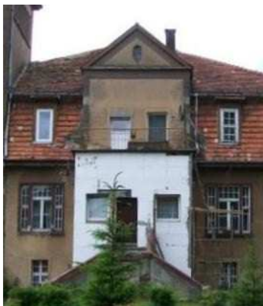
Fot. 13. Nieprawidłowo przeprowadzony remont w pałacu w Kozach – obiekcie nie wpisanym ani do rejestru zabytków ani do gminnej ewidencji zabytków
